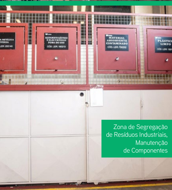
Equipamentos de Controlo da Poluição Atmosférica, Manutenção de Motores
